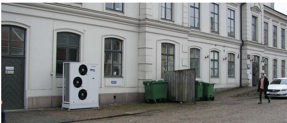
Bilden visar den tekniska anläggningen för luftkonditionering som står mot byggnadens norra fasad.
