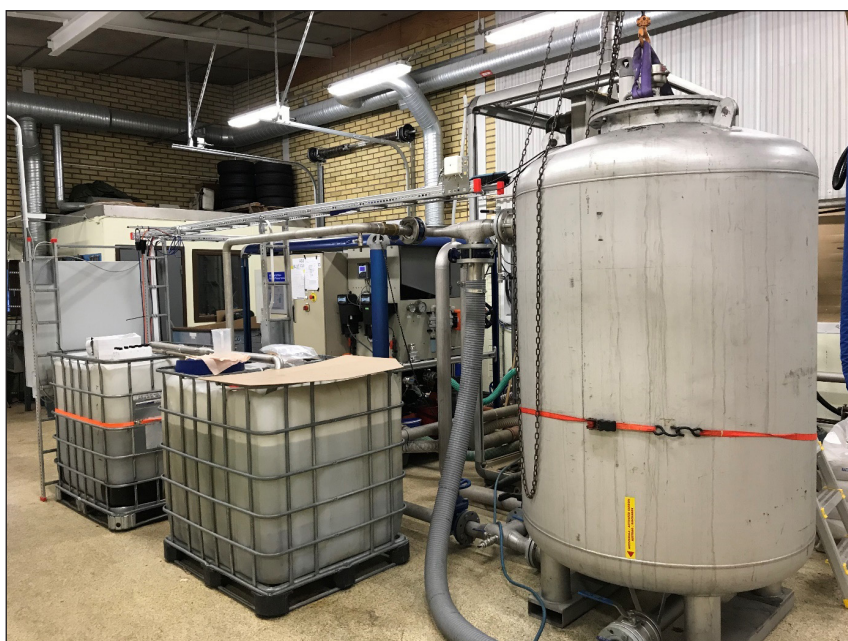
Figur 2.4 Pilotanläggning med GAK-filter till höger i bild. Utjämning av vattenflödet efter UF-anläggningen skedde i två cipaxtankar (till vänster i bild). UF-anläggningen är placerad bakom kolfiltret.
