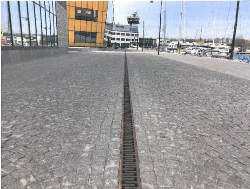
Figur 7 Exempel på dagvattenränna för linjeavvattning vid Linnéuniversitetet i Kalmar.
