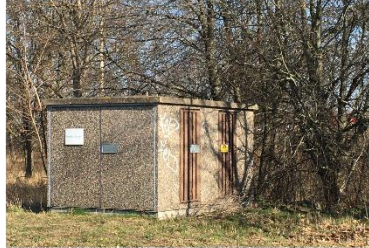
Befintlig transformatorstation inom planområdet
