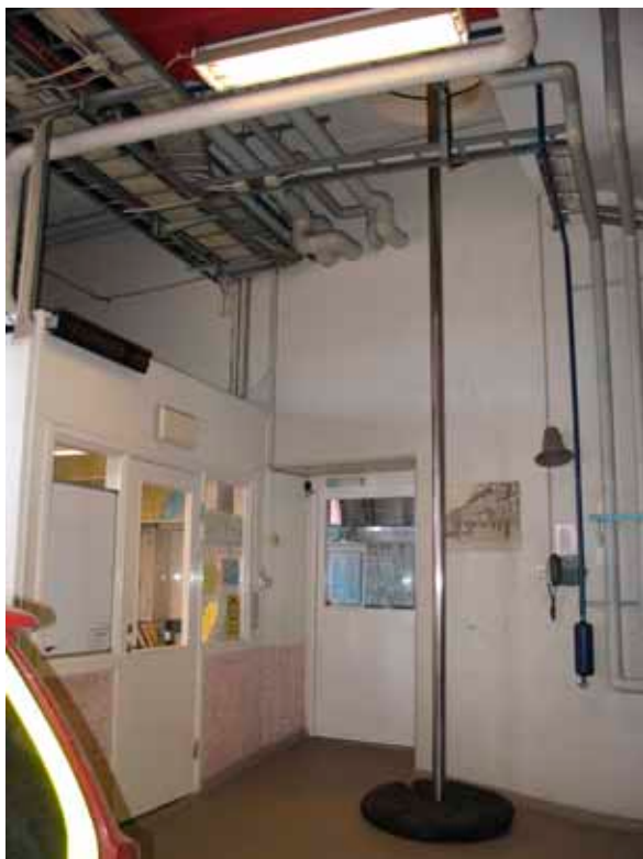
En av dagens brandstänger från logementen på andra våningen ner till vagnhallen.
