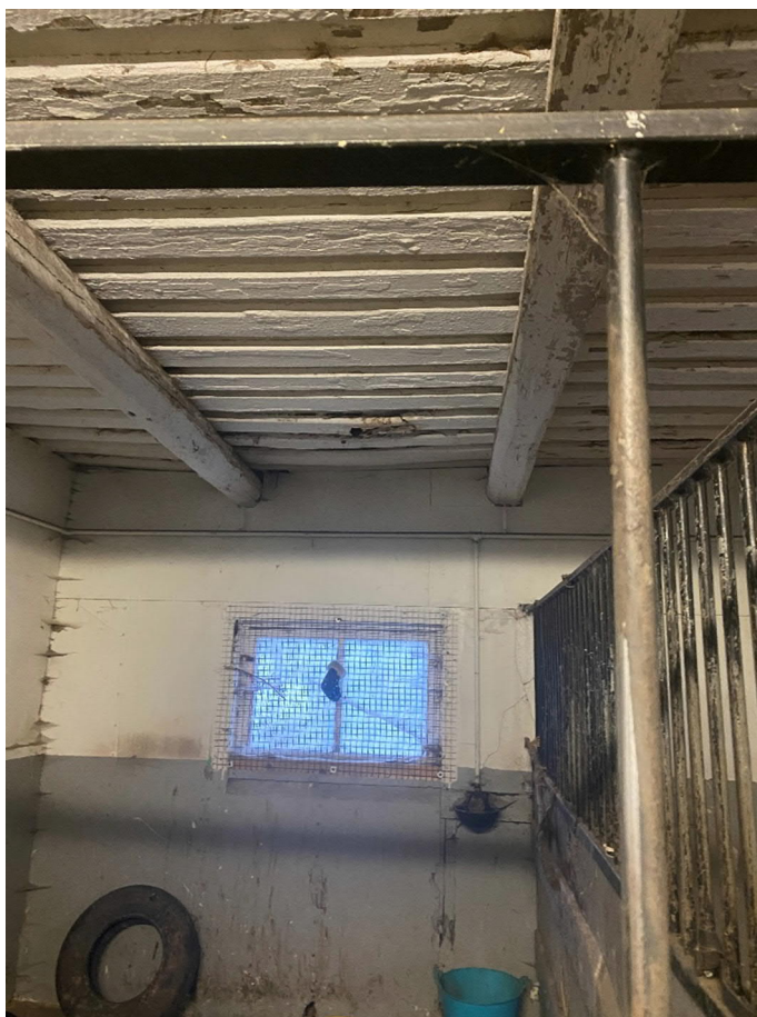
Bild 10 – Byggnad 2, tecken på läckage från tak. Fasad mot öster (innergård) har rötskador vid fot.
