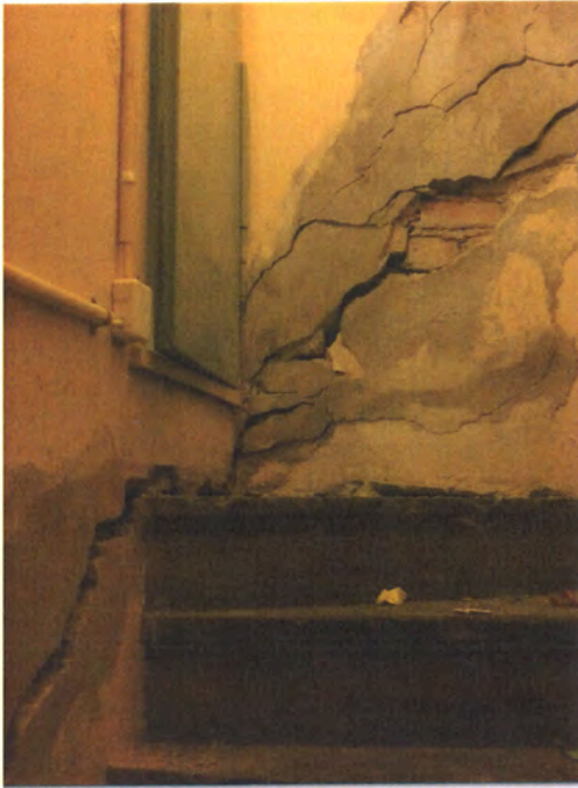
Ovan: Sprickor i trappan.
