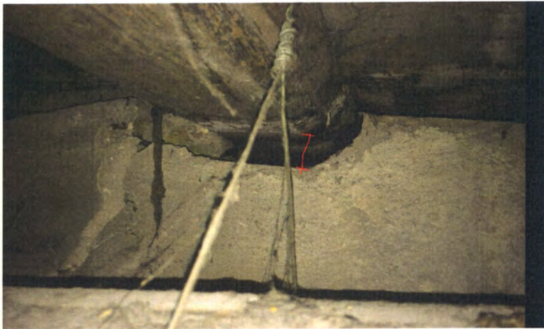
Ovan: Bjälken vilar inte på muren.
