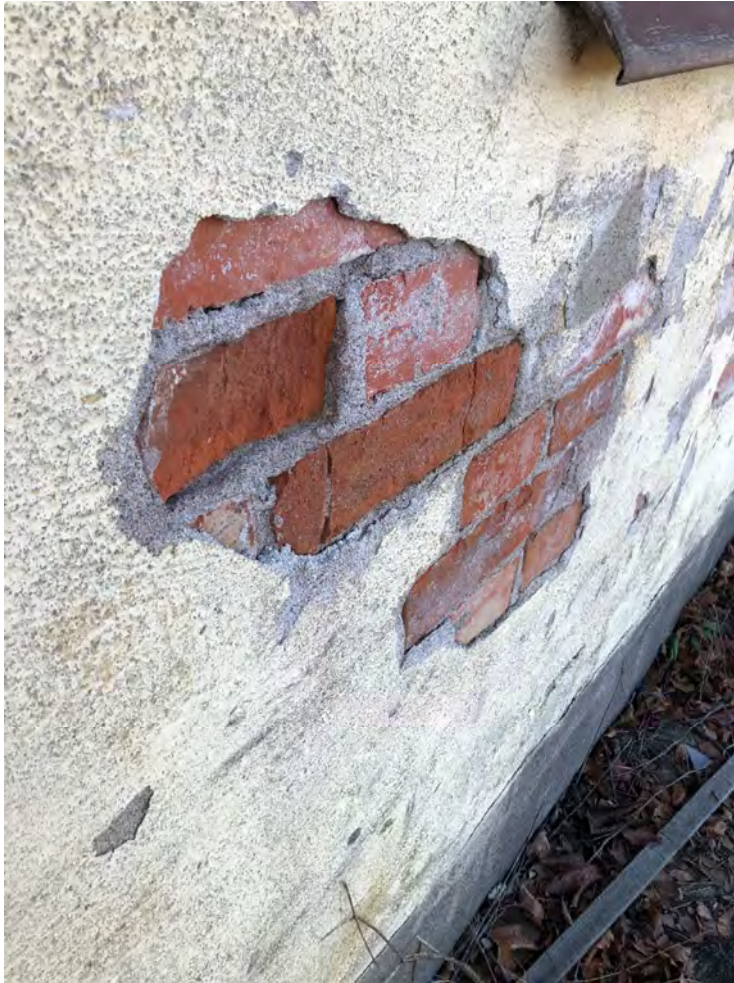
Puts med bakomliggande tegel flagnar.
