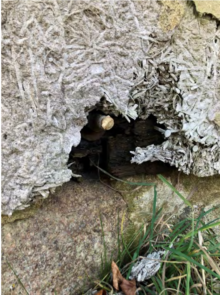
Puts har släppt från fasad och trä blottas.
