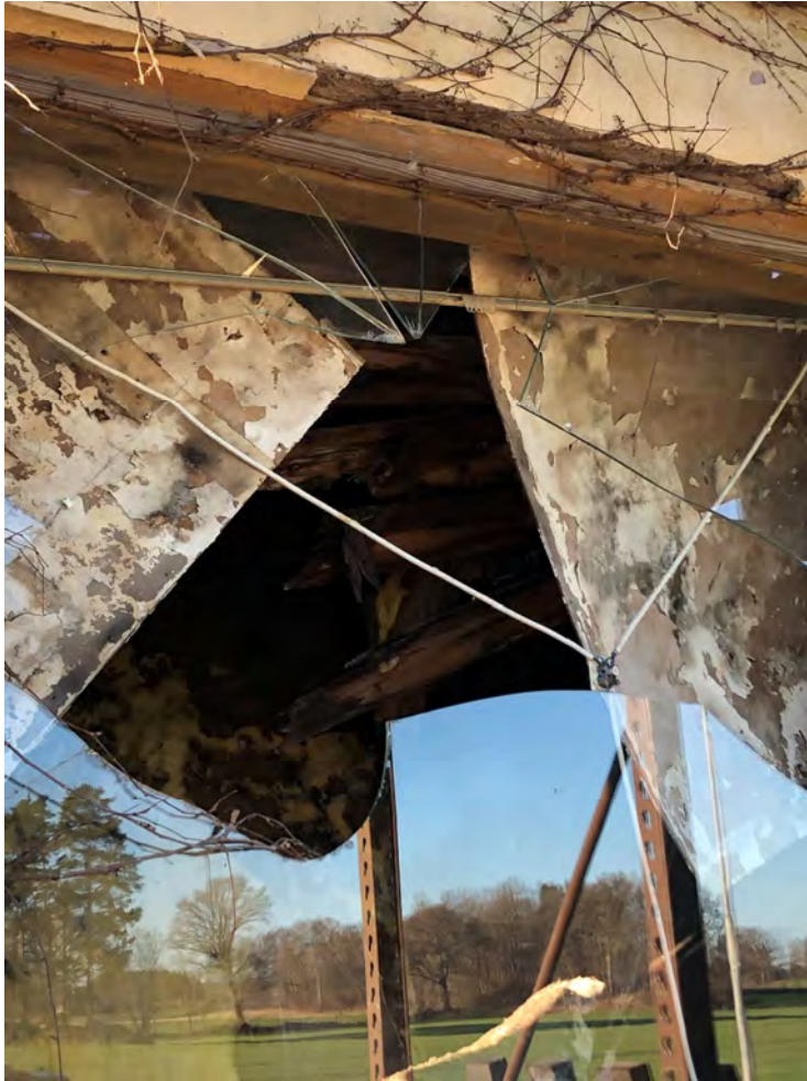
Fönster i fasad mot gata i öst är skadat med risk för skärskador.
