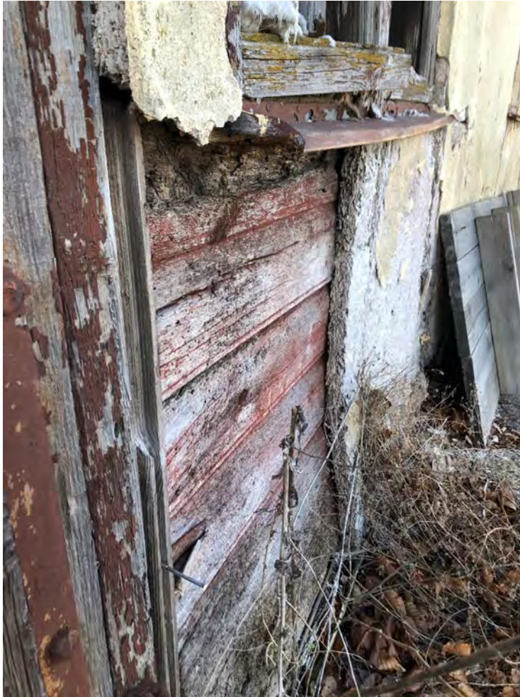
Puts har släppt under fönster vid fasad mot gata i öst.
