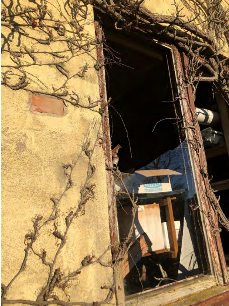
Fönster i fasad mot söder. Trasigt fönster med risk för skärskador.
