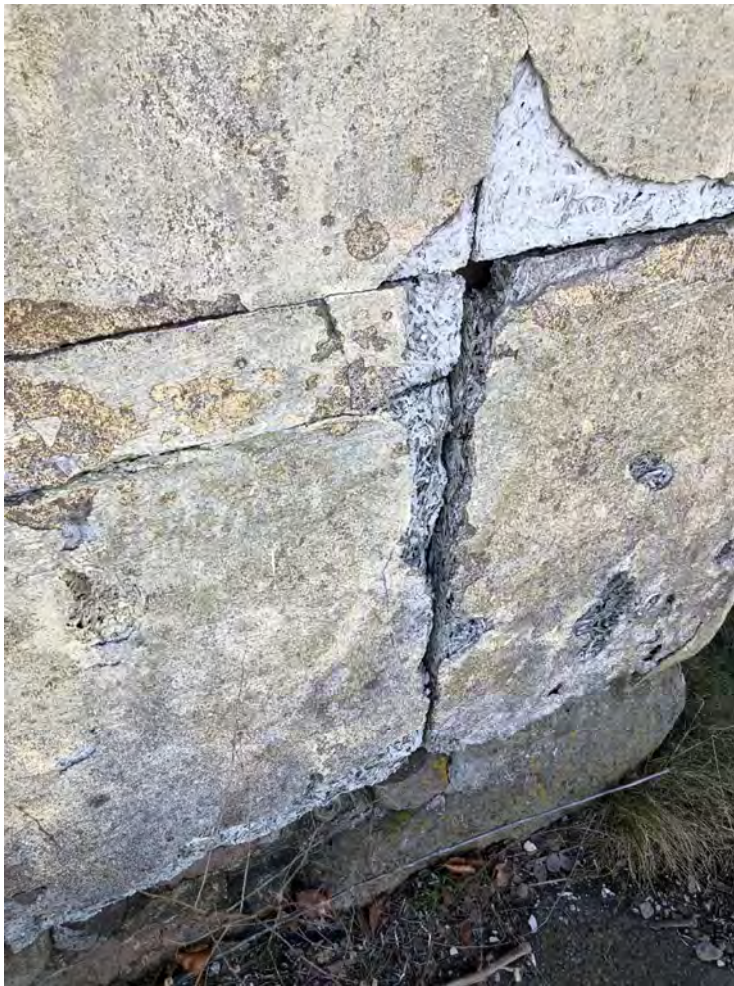
Sprickor i fasad med risk för inträngande fukt i konstruktionen.
