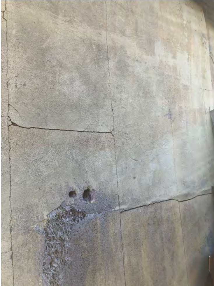
Fasad spricker vid skarv av bakom liggande skiva.
