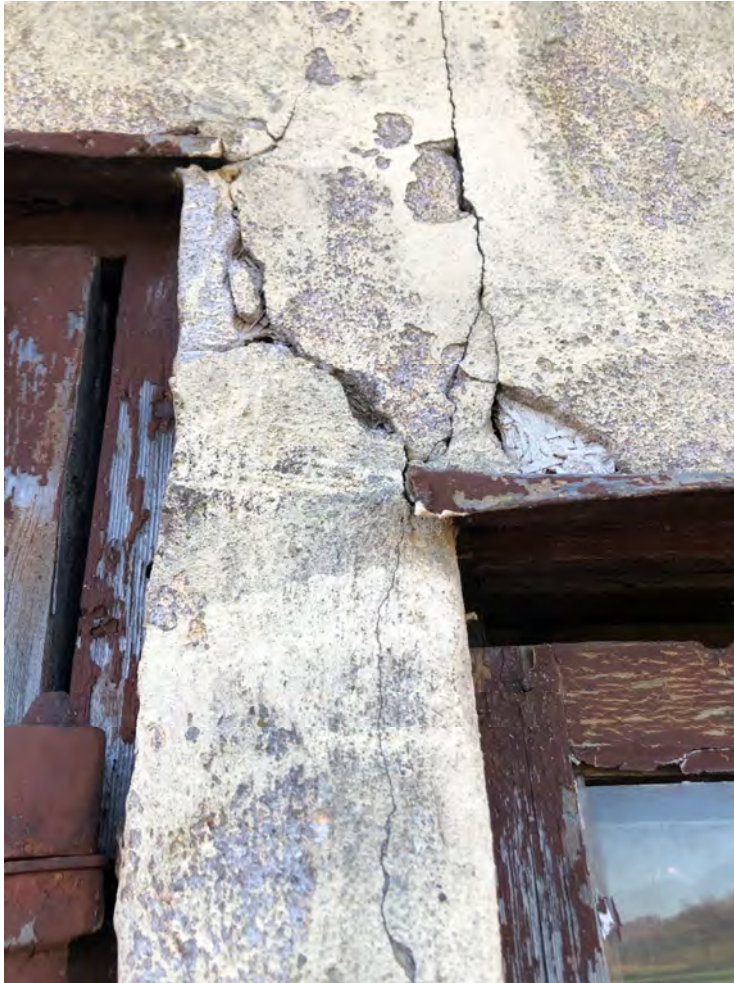
Sprickor i fasad mellan fönster och dörr vid fasad mot gata i öst.
