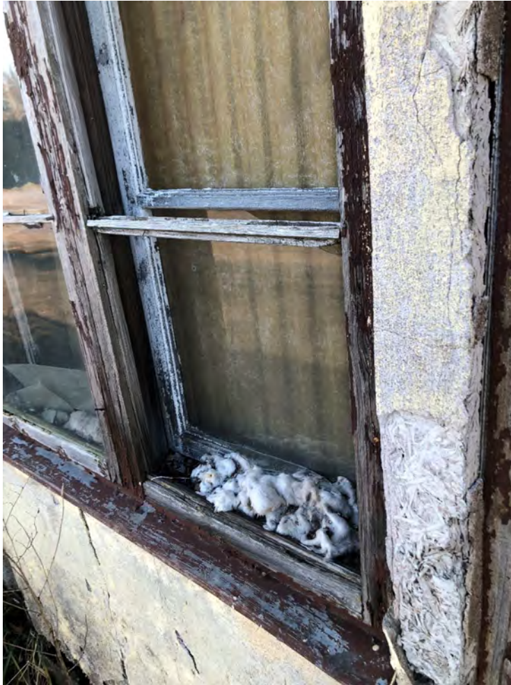
Fasad mot gata i öst. Skadat fönster. Puts har släppt från bakomliggande skiva.
