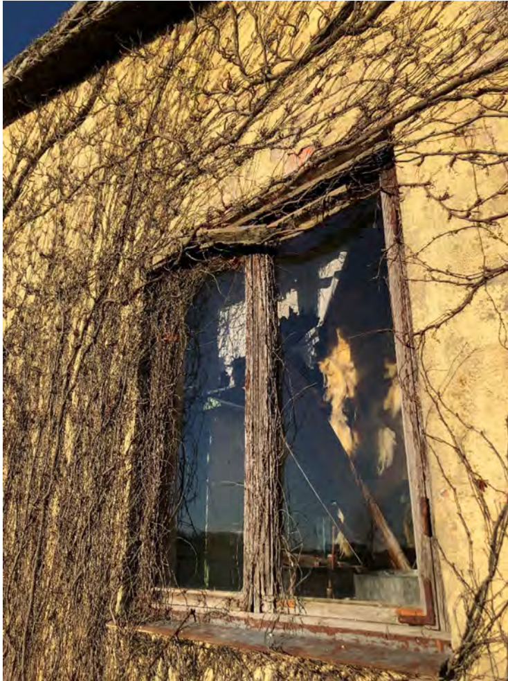
Fönsterbågens överkant vid fönster i fasad mot söder har utsatts för röta och släppt från konstruktionen.
