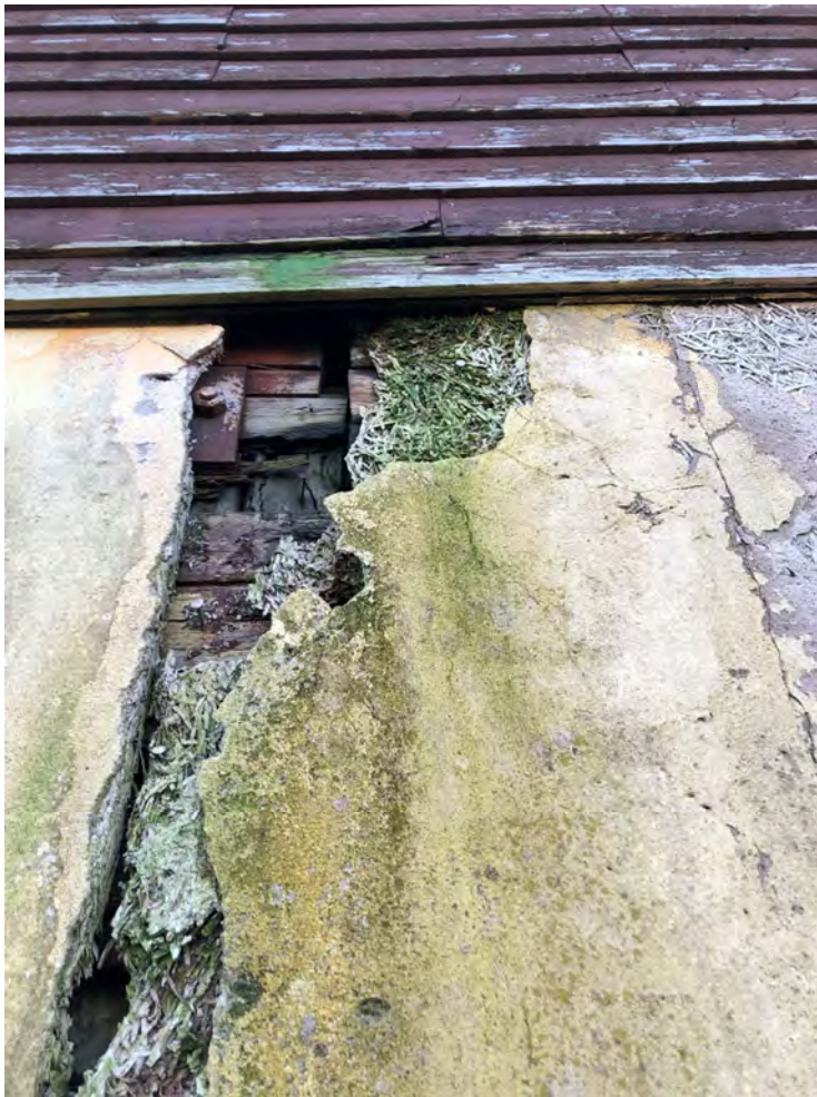
Puts släpper och blottar underliggande material vid fasad mot norr. Fuktinträngningen har skett och fasadmaterialet är väsentligt skadat.
