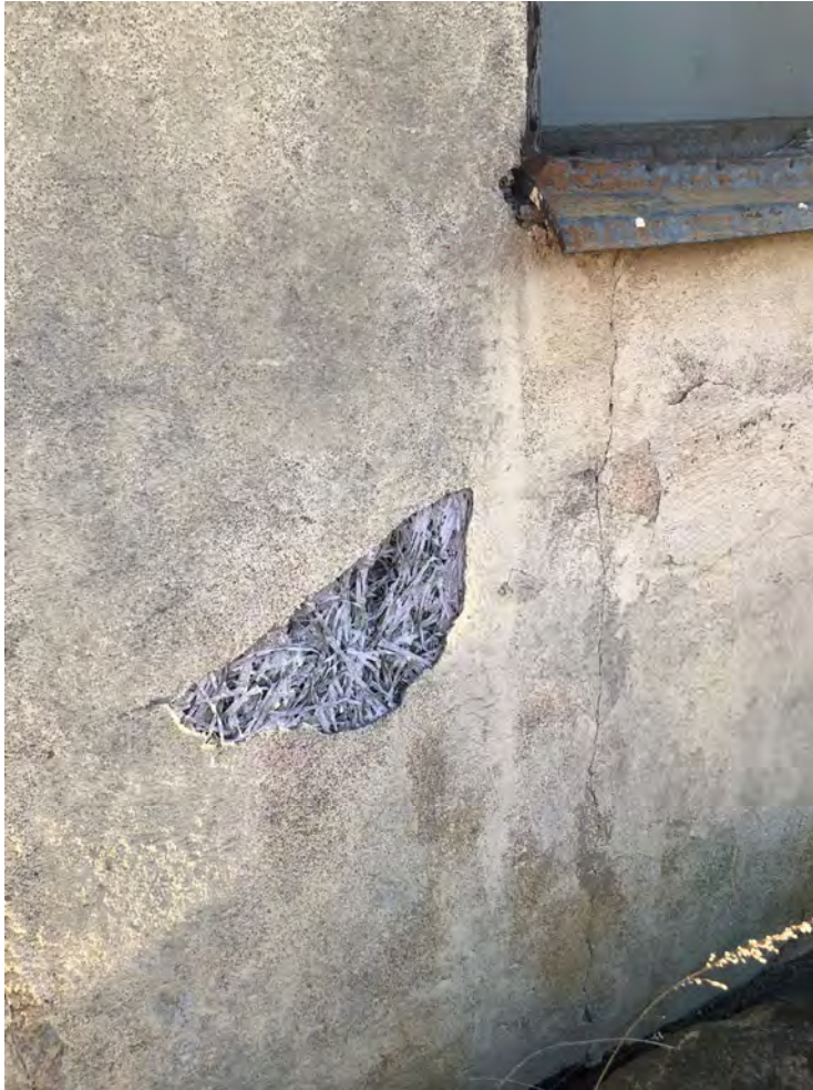
Puts har släppt från bakomliggande träfiberskiva.
