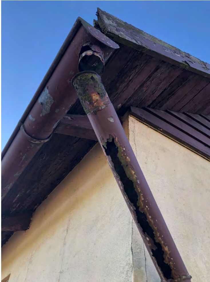
Hängränna och stuprör vid byggnadens nordöstra hörn har roststat sönder.
