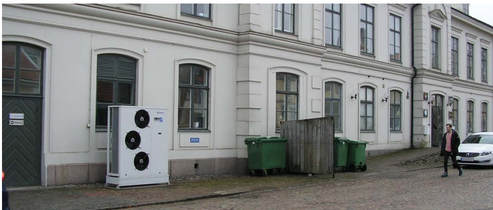
Bilden visar den tekniska anläggningen för luftkonditionering som står mot byggnadens norra fasad.
