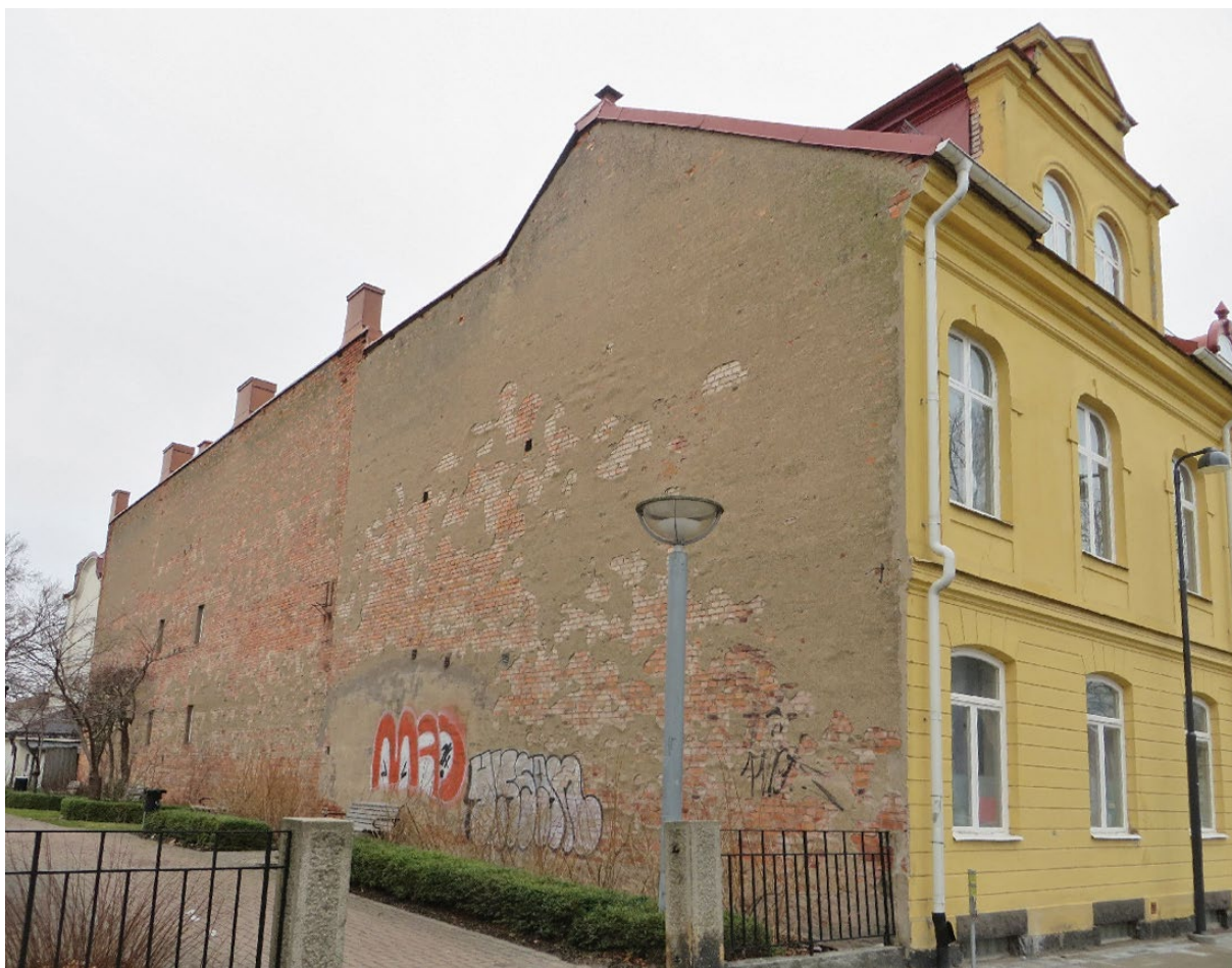
Bild 26. Gathusets brandgavel och gårdshusets brandvägg, vilka aldrig kommit att byggas emot.
