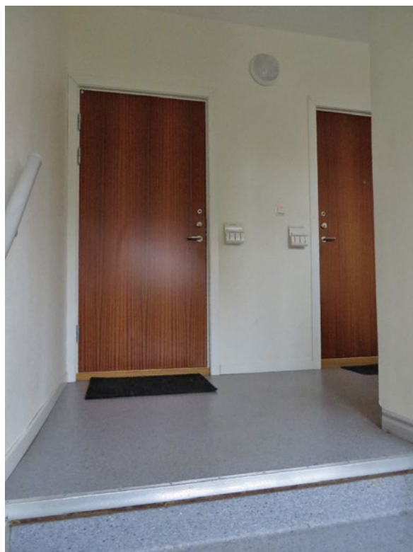
Bild 29. I gårdshusets enda trapphus har flera förändringar skett sedan uppförandet: trapploppet har troligen vänts, dörrar satts igen och lägenhetsdörrarna bytts ut mot moderna från omkring 1960-talet.
