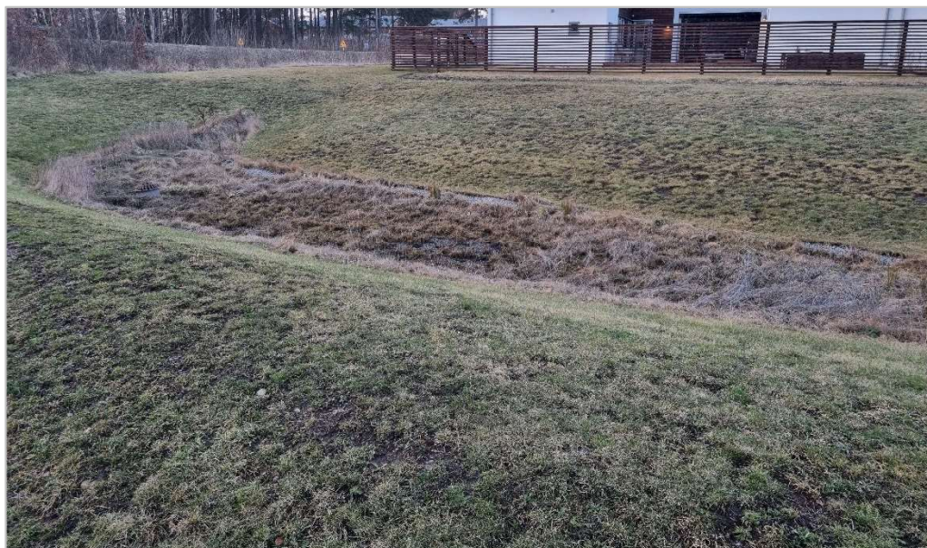
Figur 10. Nedsänkt infiltrationsyta för villaområde, Svensknabbevägen Kalmar.
