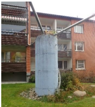
Cistern. kv Inspektoren
