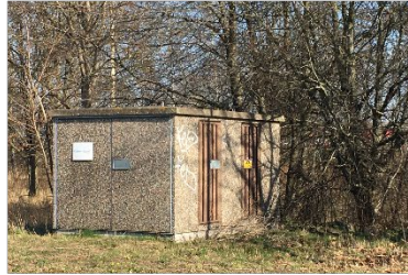
Befintlig transformatorstation inom planområdet
